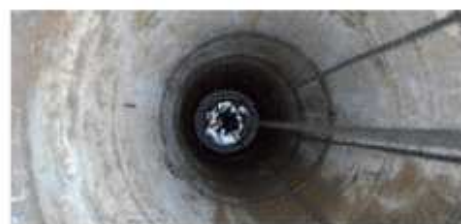
Колодцы на воду
